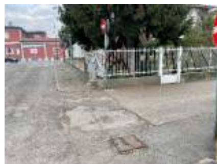
B1.4 dissesto pavimentazione
