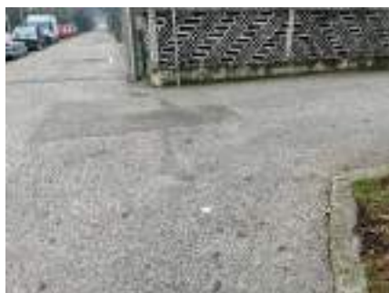
B1.6 mancanza attraversamento pedonale
