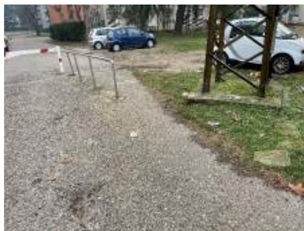
B1.4 dissesto pavimentazione
