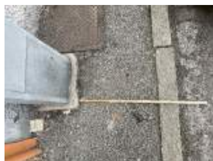
B1.18 ostacolo su percorso pedonale
