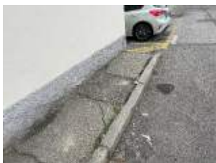
B1.4 pavimentazione dissestata
