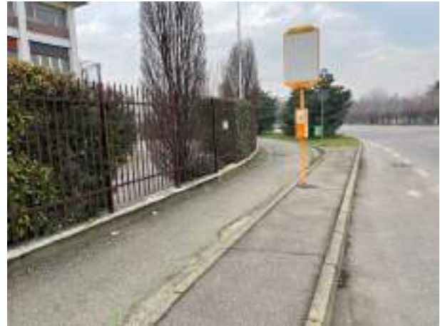
B1.16 ostacolo segnaletica
