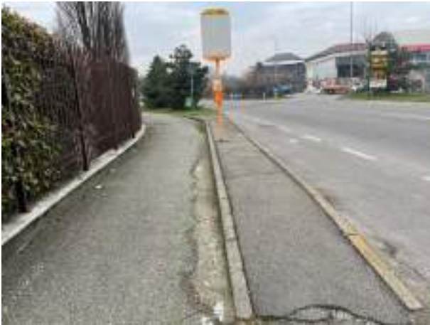
B1.4 pavimentazione dissestata
