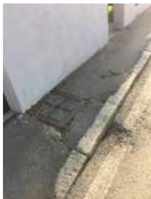
39 B1 -4 Dissesto pavimentazione
