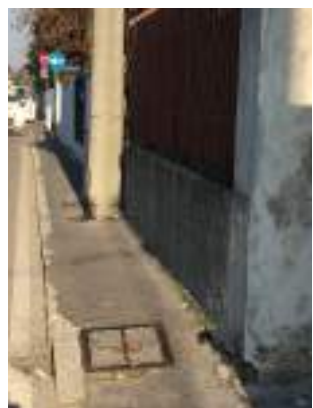
42 B1 -4 Dissesto pavimentazione
