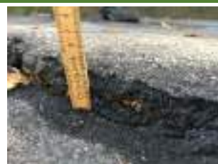
B1.4 pavimentazione dissestata
