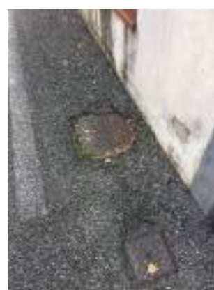
D87 B1.4 Disconnessa
