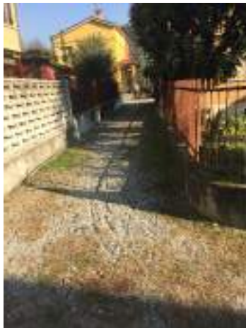
B1. 4- Pavimentazione sconnessa
