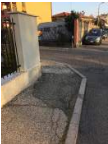
B1.6 Manca attraversamento pedonale
