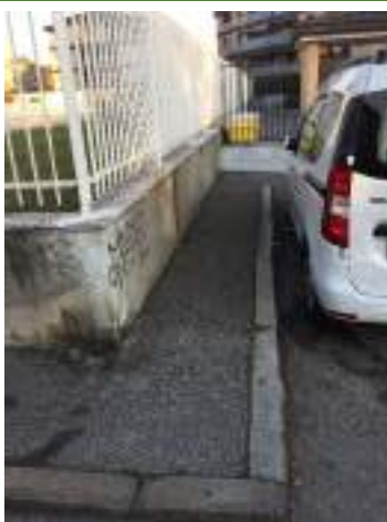
B1.4 pavimentazione dissestata
