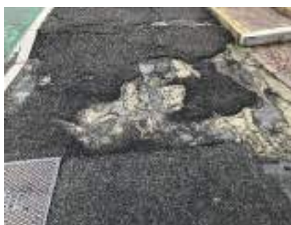
B1.4 dissesto pavimentazione
