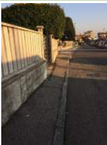
B1.4 pavimentazione sconnessa e degradata
