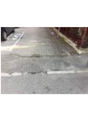
9 B1 -4 Dissesto pavimentazione
