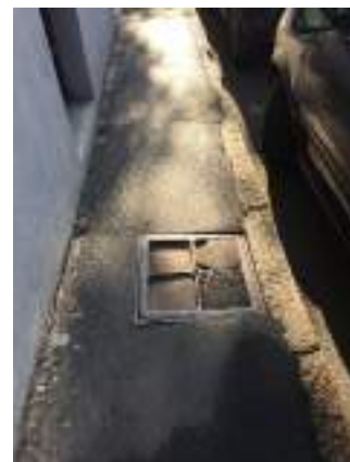
59 B1 -4 Dissesto pavimentazione
