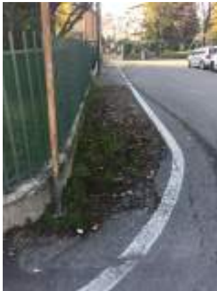
B1. 4 Pavimentazione sconnessa
