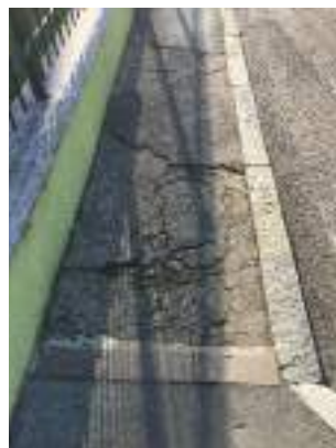
6.B1 -4 Dissesto pavimentazione
