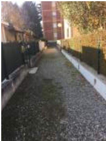
B1. 4- Pavimentazione sconnessa
