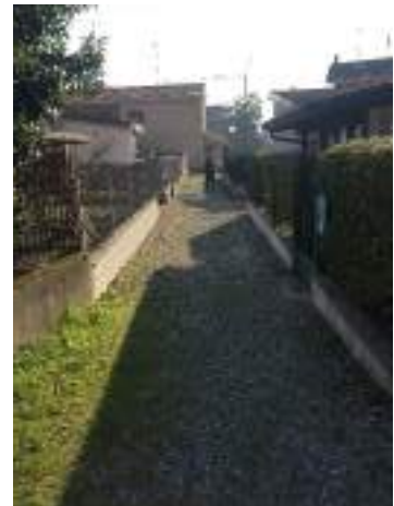
B1. 4- Pavimentazione sconnessa
