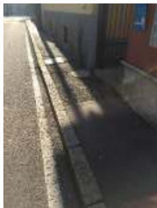
57 B1 -4 Dissesto pavimentazione
