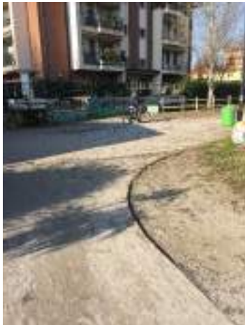
B1-4 Pavimentazione dissestata
