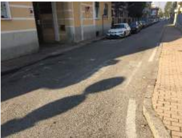
B1.6 - Mancanza percorso pedonale protetto
