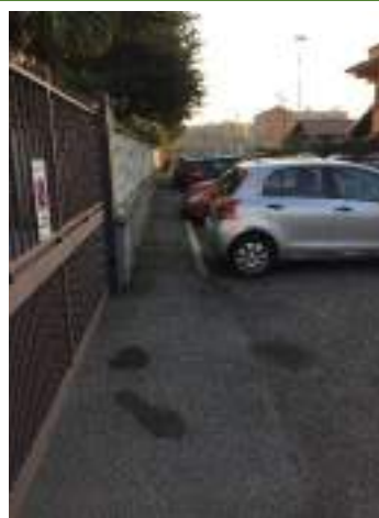
B1.4 pavimentazione dissestata
