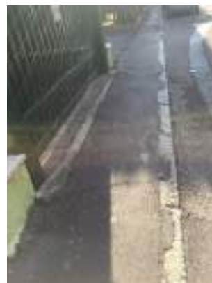
7. B1 -4 Dissesto pavimentazione
