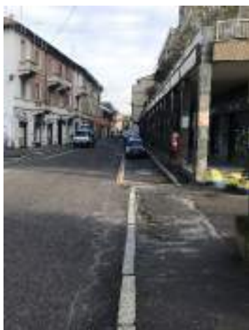
B1.4 pavimentazione dissestata
