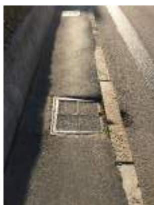
26 B1 -4 Dissesto pavimentazione
