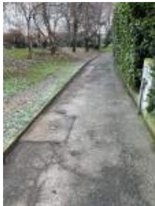
B1.159 B1.4 dissesto pavimentazione
