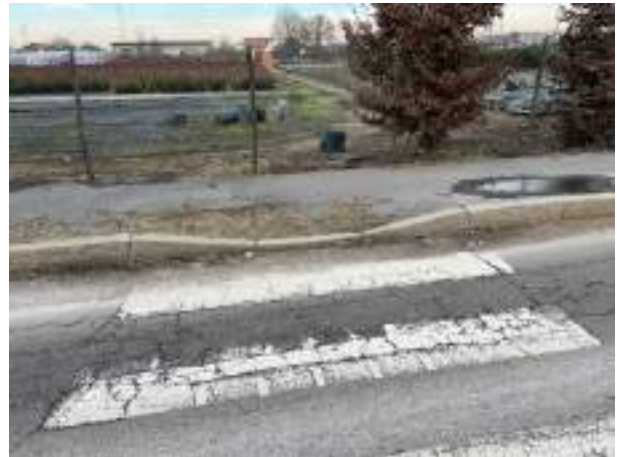
B1.4 dissesto pavimentazione
