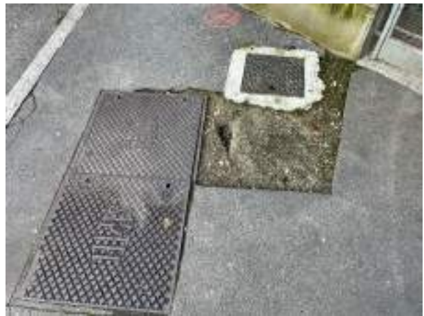
B1.5 pozzetto non in quota
