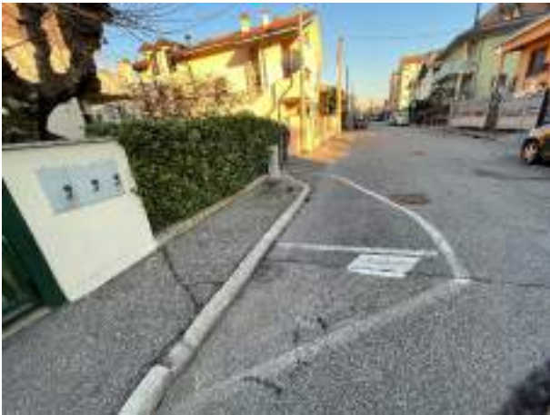
B1.6 manca attraversamento su percorso protetto
