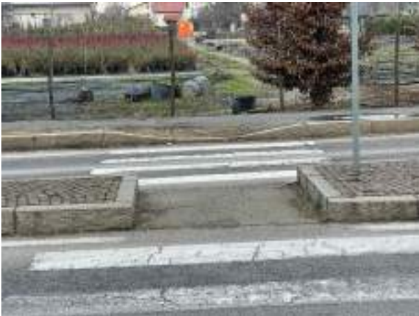
B1.6 mancanza segnaletica tattile su attraversamento
