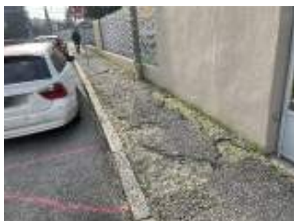
B1.4 dissesto pavimentazione
