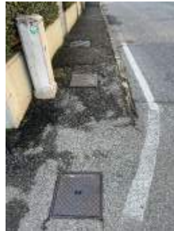
B1.4 dissesto pavimentazione
