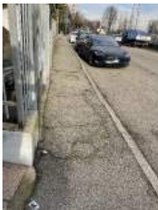
B1.4 dissesto pavimentazione
