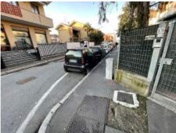
B1.4 dissesto pavimentazione
