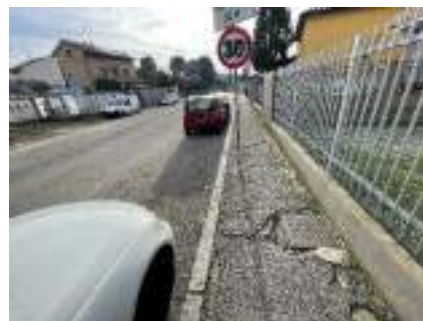
B1.4 dissesto pavimentazione
