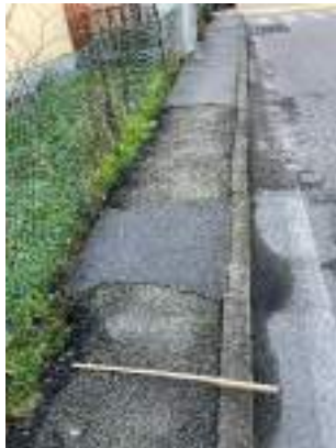
B1.4 dissesto pavimentazione
