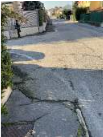
B1.6 mancanza segnaletica orizzontale e segnaletica tattile
