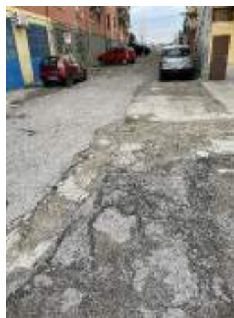
B1.4 dissesto pavimentazione
