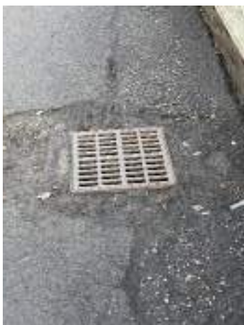
B1.4 dissesto pavimentazione
