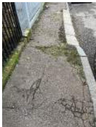
B1.4 pavimentazione dissestata
