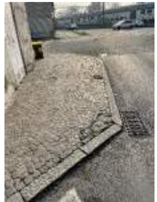
B1.4 dissesto pavimentazione
