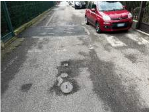
B1.6 mancanza attraversamento stradale
