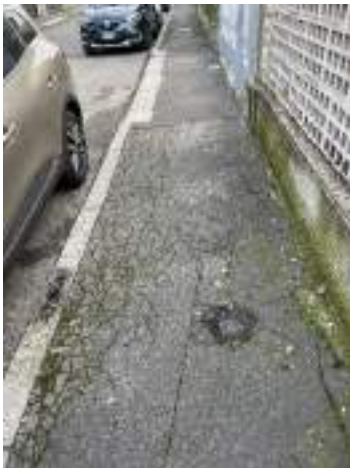
B1.4 pavimentazione dissestata
