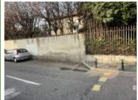
B1.21 mancanza segnaletica orizzontale
