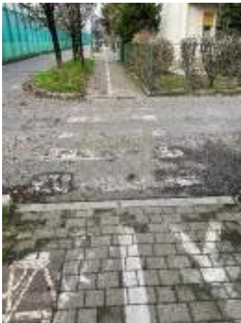
B1.4 dissesto pavimentazione
