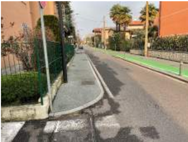
B1.4 pavimentazione sconnessa
