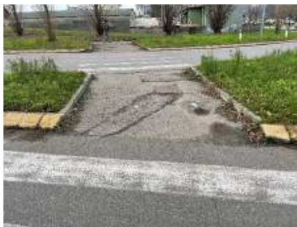
B1.4 dissesto pavimentazione
