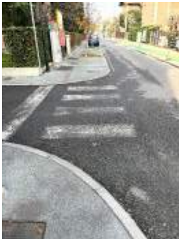
B1.21 mancanza segnaletica orizzontale
