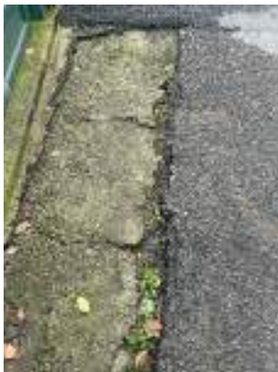
B1.4 Dissesto pavimentazione
