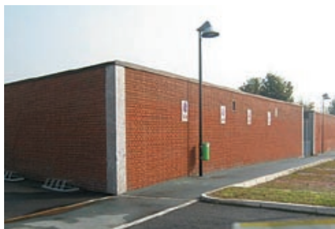
Il muro del Cimitero di via IV novembre ripulito dalle scritte
